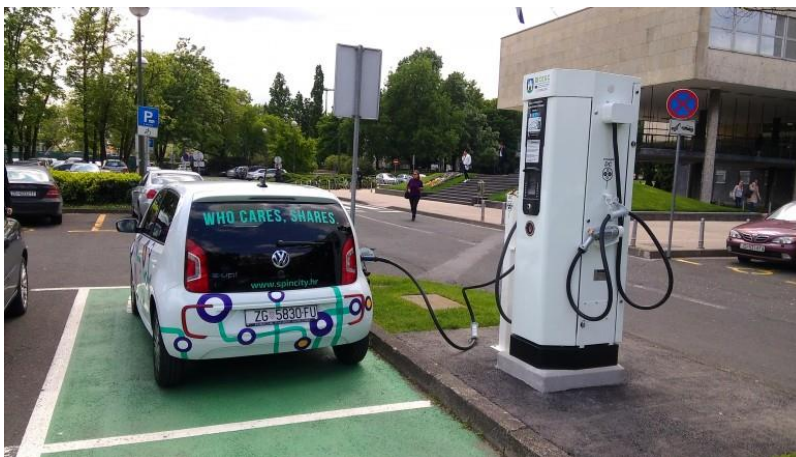
Stanica za punjenje električnih vozila u Zagrebu (izvor: prom.com.hr )
